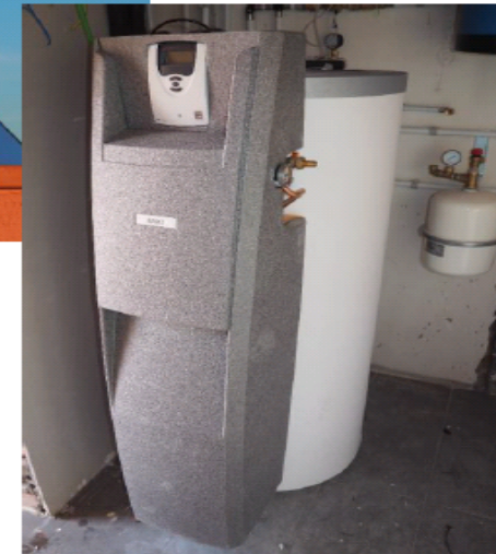
Acumulador del panel solar
