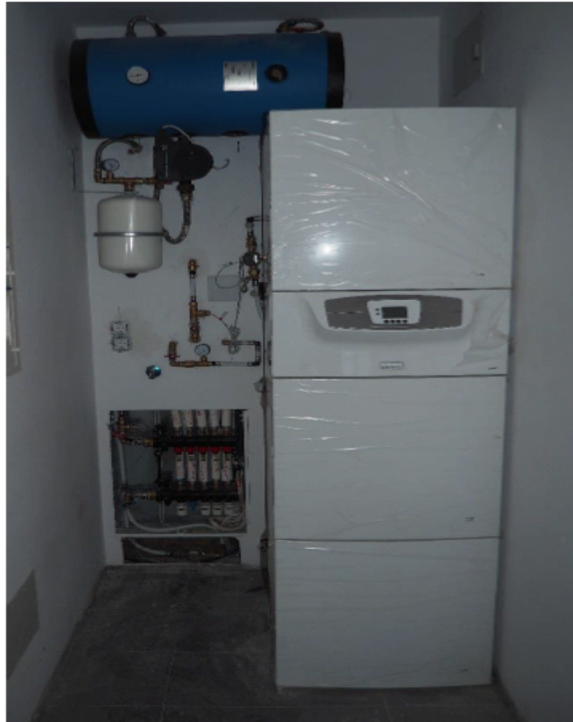
Bomba de calor de aeorotermia
