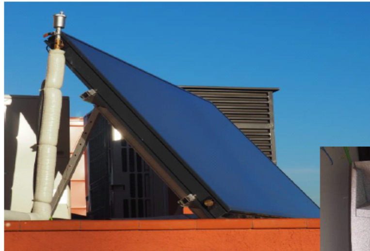
Panel solar térmico
