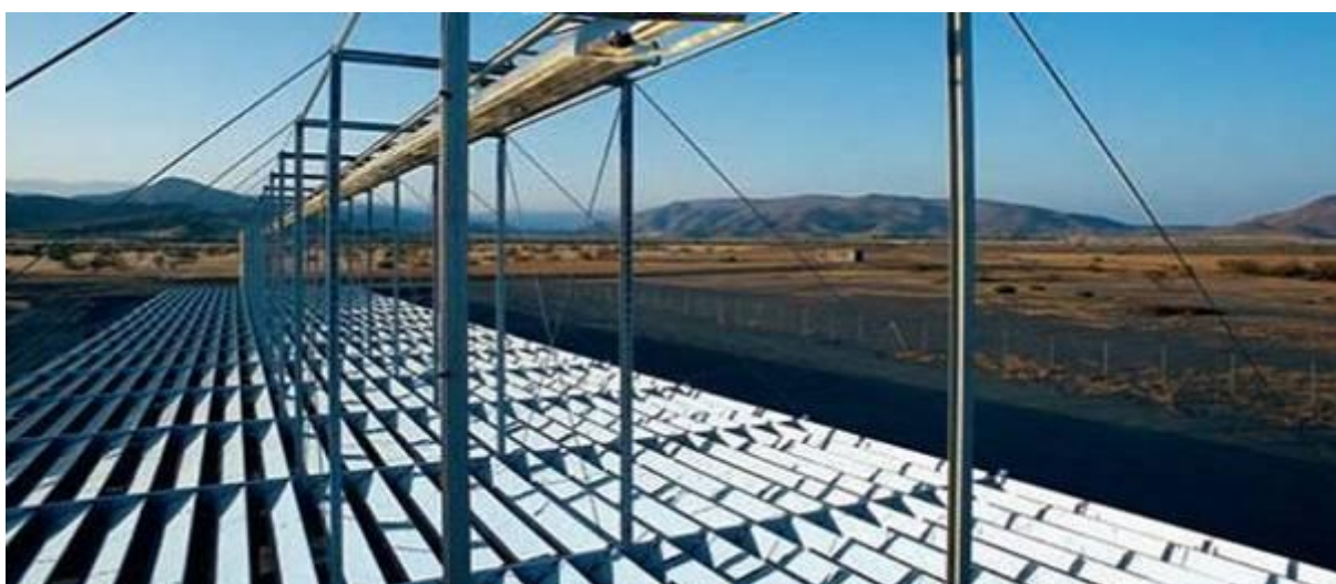
Figura 4.11.9. Instalación de colectores lineales de Fresnel en la Plataforma Solar de Almería
