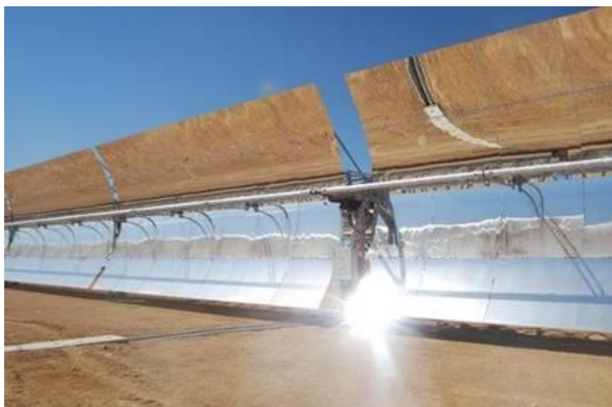
Figura 4.11.6. Detalle de campo solar de una central cilindroparábólica
